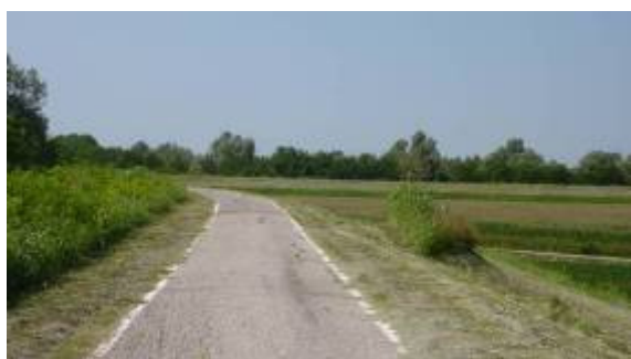
La ciclovia 2d in direzione Ostiglia; pavimentazione con buche e avvallamenti da sistemare
